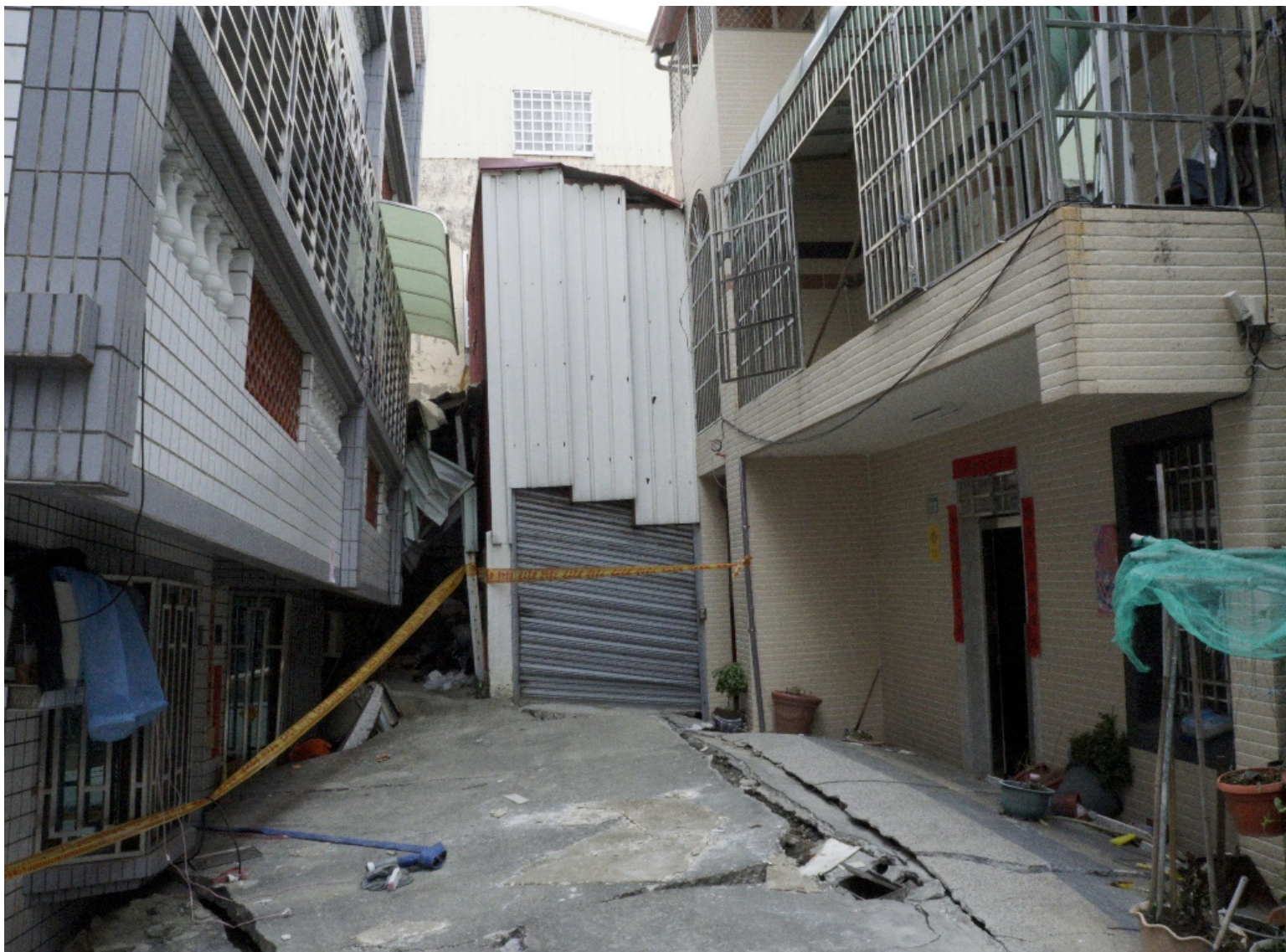
建物沉陷及傾斜。
