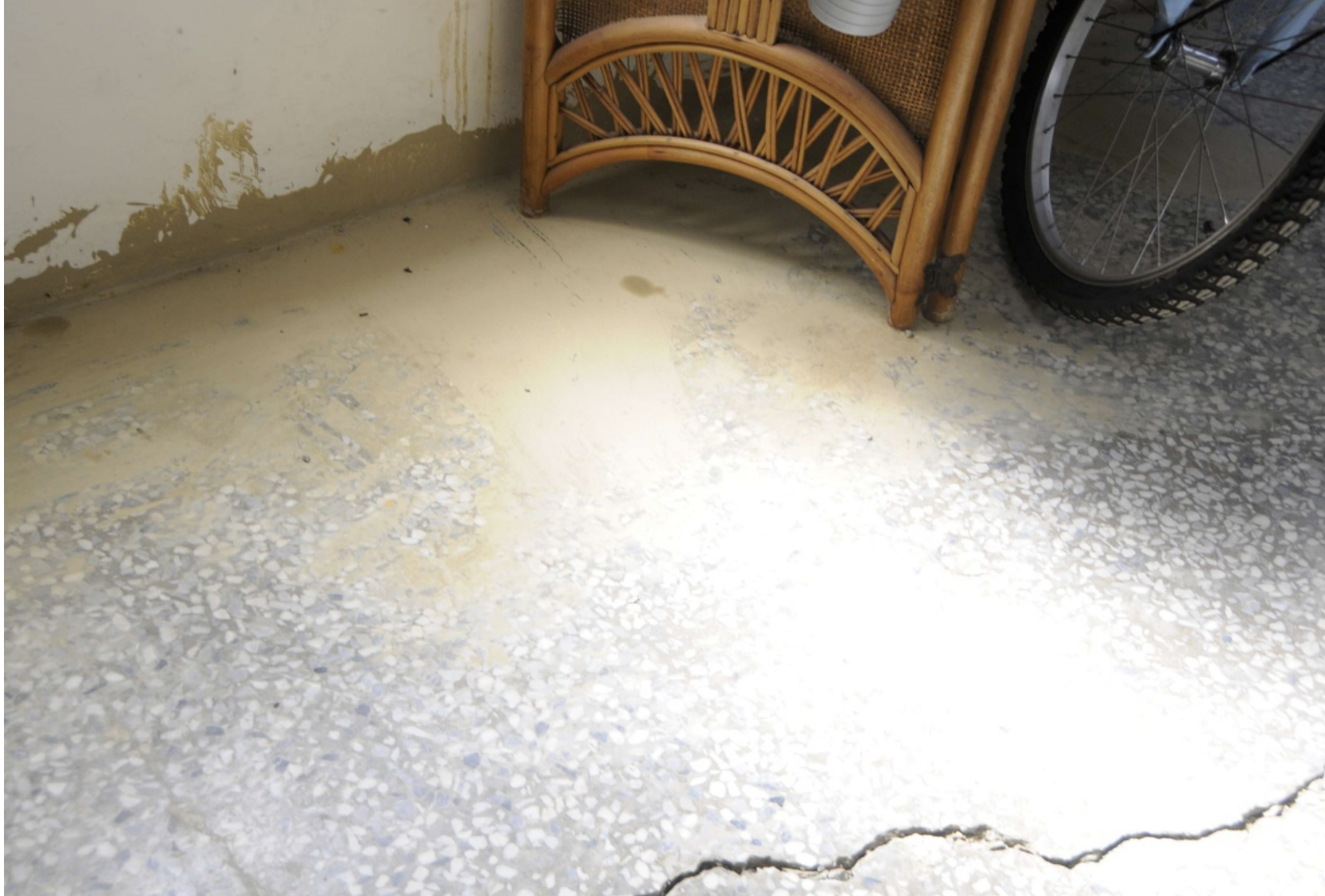
地面破裂與噴砂
